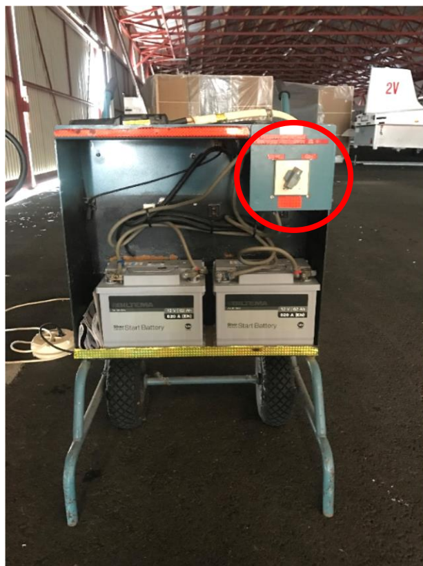
Fig. 5 – Batterivagn val av 12/24 v.
